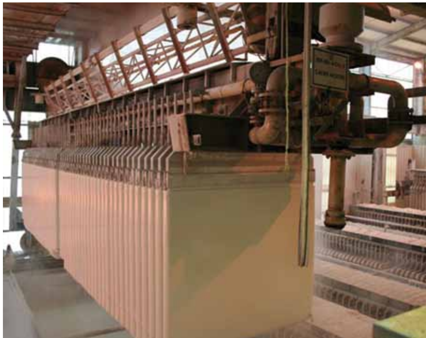
Filtry płytowe w fabryce chemicznej
