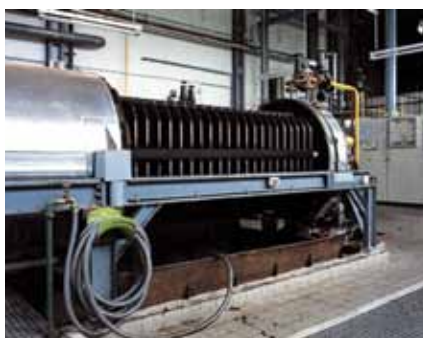
Filtr płytowy gotowy do sprawdzenia i oczyszczenia
